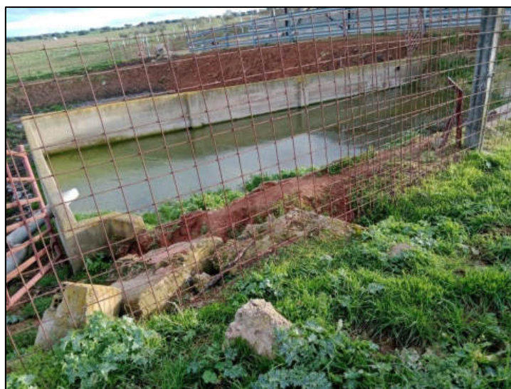
Figura 8. Detalle del estercolero y fosa de lixiviados y aguas de limpieza con cerramiento perimetral.
